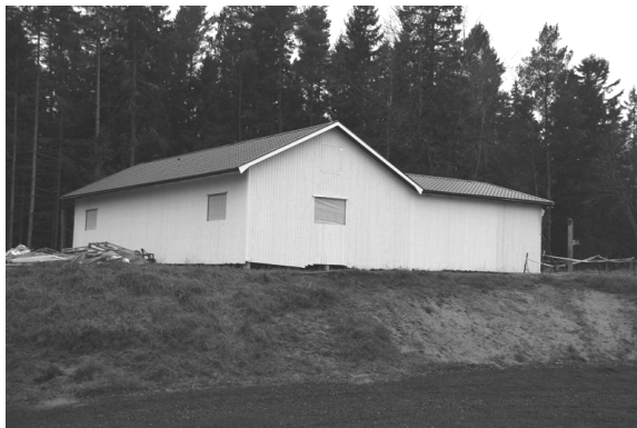
I december var den grundmålade väggpanelen klar. Efter detta är numera alla fönster monterade.
