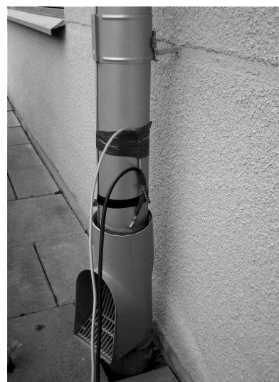
En provisorisk antenn: Ett stuprör där koaxens inneledare är ansluten till stupröret och skärmen till en provisorisk jordledning
