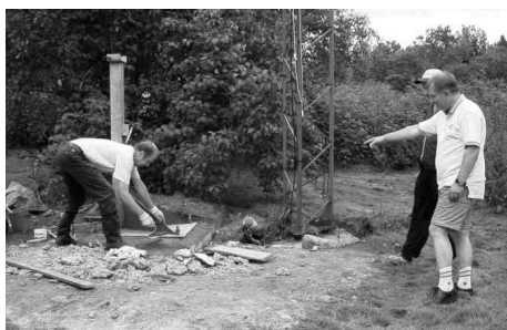
HCW arbetar med undergrutningen av fästet. "Goda råd" ges här av SYQ - Ingemar och AYA - Mikael!
